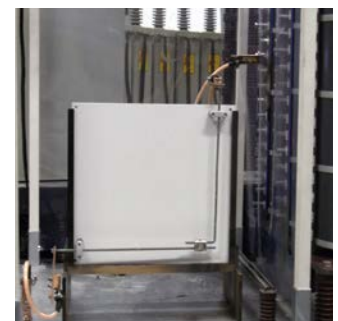
Figura 5: Provino fissato su piastra isolante (morsetto MV) per la prova ad impulso.
