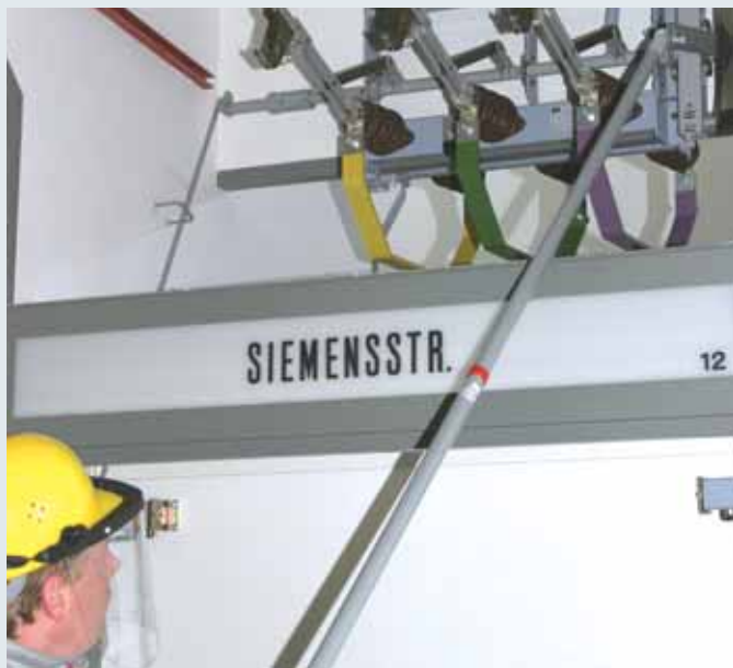
Azionamento di un sezionatore con il fioretto di manovra SCS.
