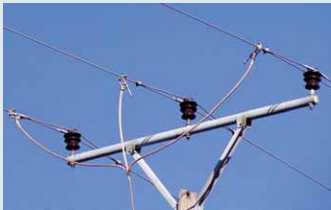
Pinza di fase su conduttori aerei.
