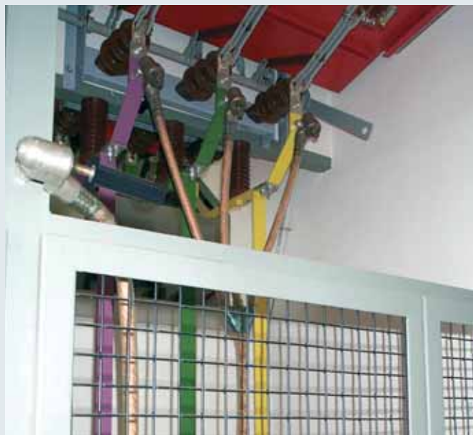
Dispositivo di messa a terra ed in corto circuito tripolare con accessori in una centrale elettrica.
